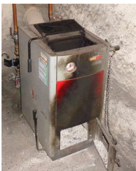
Obrázek č. 2.1.3.2: Kotel Dakon DOR 16
